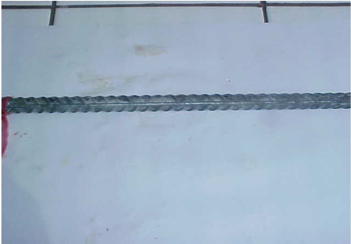
Vue de l'armature revêtue au Fluxal 9707 après 750 h d'exposition au brouillard salin
